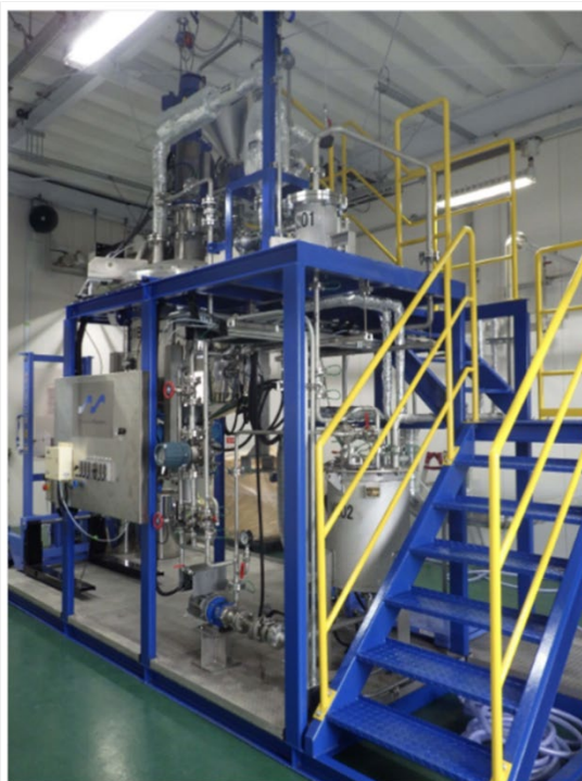
図表3 アクリル樹脂のモノマー化の実証設備
