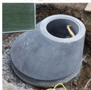
EeTAFCON研究会 下水道マンホール
