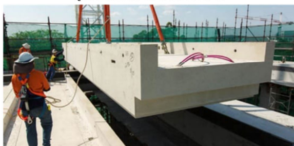
Wagners ほか Queensland大学施設のフロア材
