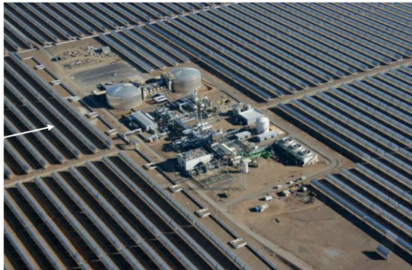
溶融塩蓄熱発電設備
