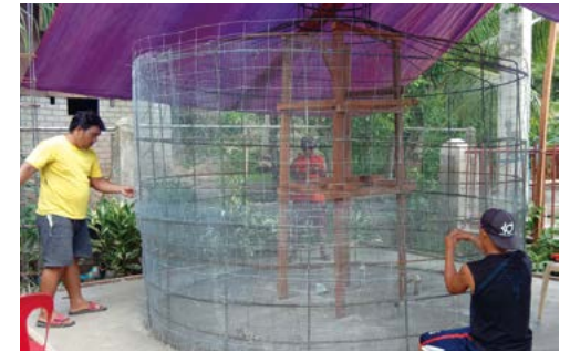
雨水貯留タンク(2019年11月)
