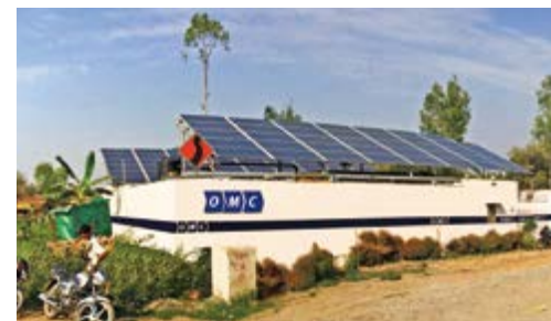
インド国内の非電化地域に設置されている小型太陽光発電
