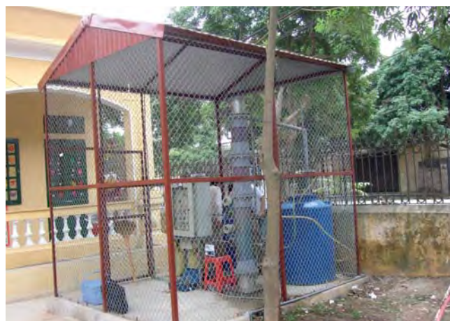
鉄バク法砒素除去パイロット施設
