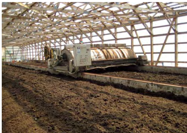
一日10トンの畜産廃棄物を堆肥化する施設
