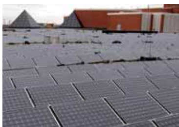
米国SunWize Technologies社により設置された太陽電池パネル
