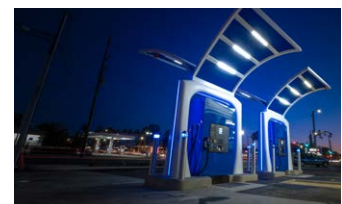
米国FirstElement Fuel社 水素ステーション
