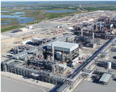
Cameron LNG全景 © Cameron LNG
