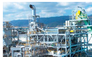
甲南ユーティリティ(株)の木質バイオマスコジェネレーション設備
