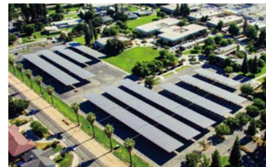
ForeFront Power社の分散型太陽光発電
