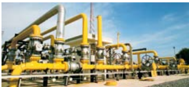
GNM社のガス配給施設（メキシコ）
