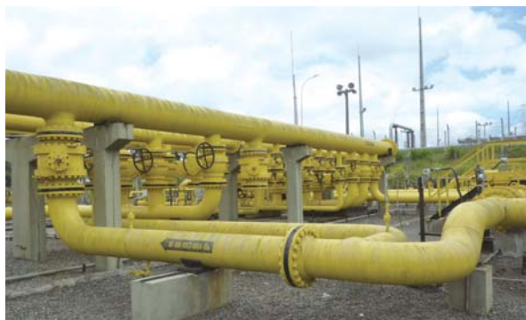
ガス配給設備
