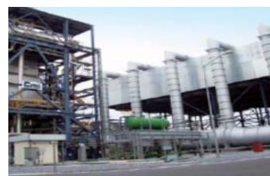
セントラル・ヴァイエ・エルモッソン (RB IV) ガス複合火力発電所 (メキシコ)
